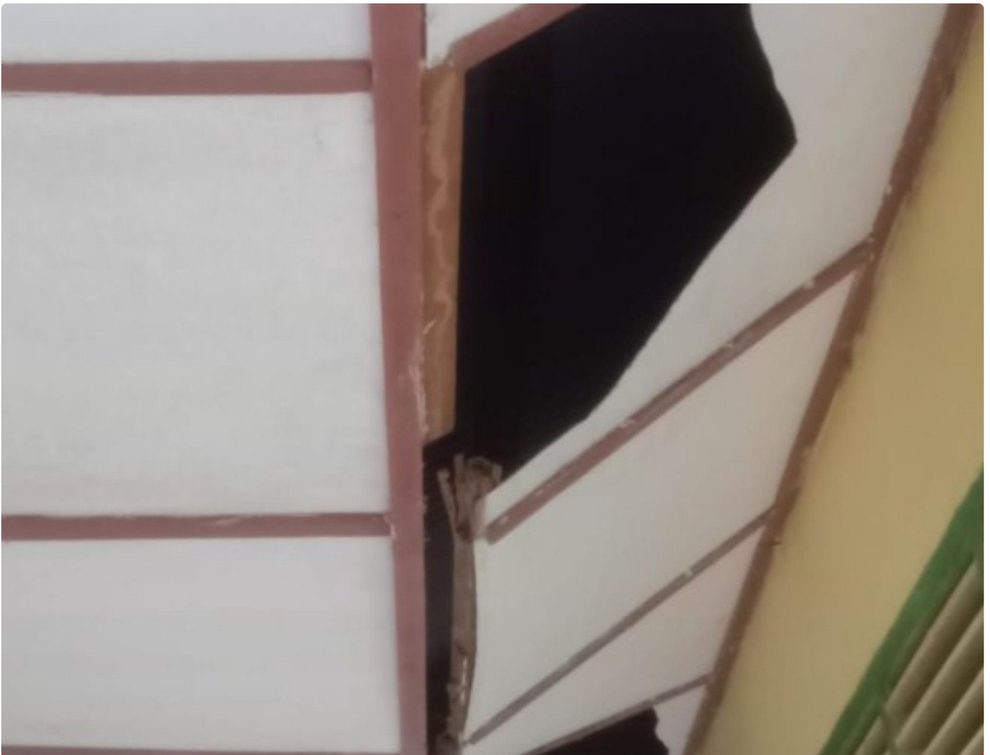
Foto: Plafon ruangan kelas UPTD SDN 67 yang rusak akibat angin kencang
