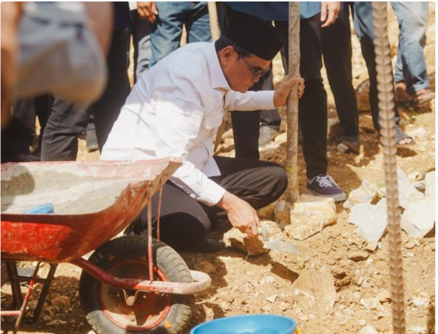
Bupati Barru Ir. H. Suardi Saleh.,M.Si melakukan peletakan batu pertama pembangunan musallah Al Akshah di Warekke, Dusun Tille, Desa Mattirowalie
