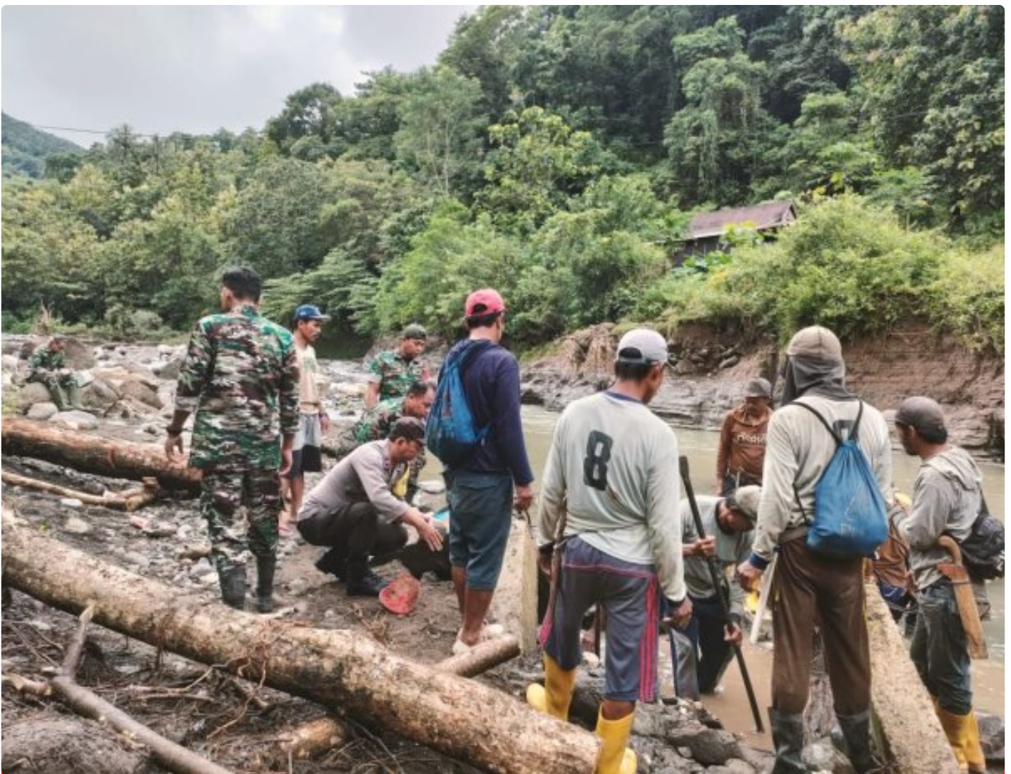
Aipda Asdar bersama Personel Koramil dan Warga Desa Harapan saat membangun jembatan darurat.
